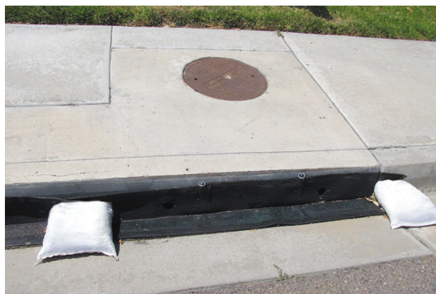
Cổng thoát nước mưa được che lại
