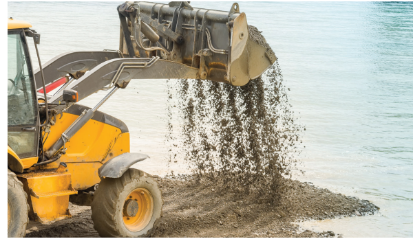
پر کردن — هر موادی که در پهنه‌های آب (یا کانال‌ها/بسترها/سواحل آنها) قرار گیرد. نمونه‌هایی از آن عبارتند از صخره، شن، خاک، پلاستیک، نخاله ساختمانی، لوله‌ها/زیرآبگذر و تراشه‌های چوب می‌شود، ولی محدود به آنها نیست.
